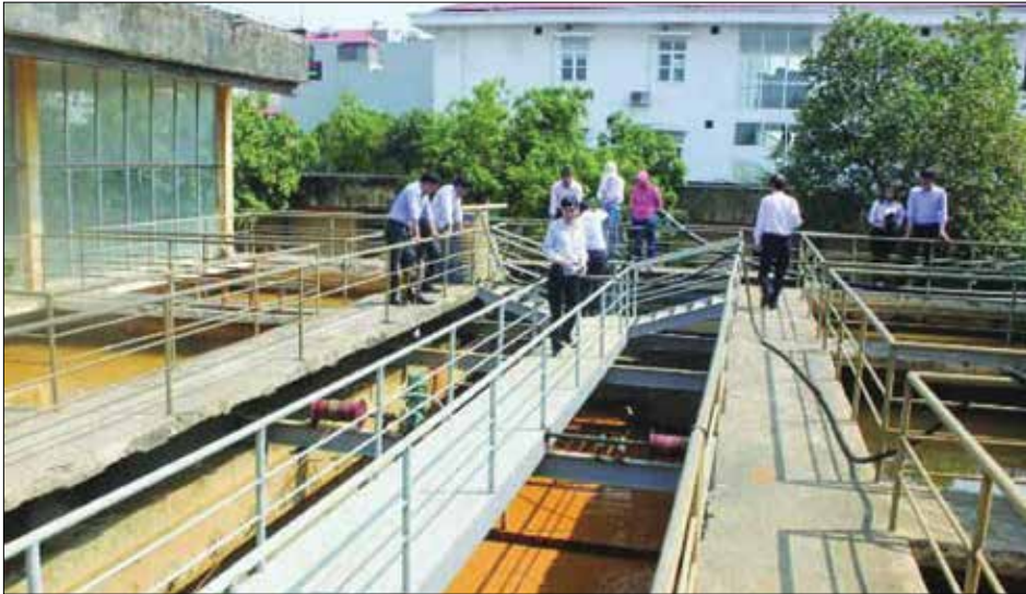
▲ Hệ thống xử lý tuần hoàn tại Nhà máy nước Ba La, Công ty TNHH MTV Nước sạch Hà Đông
